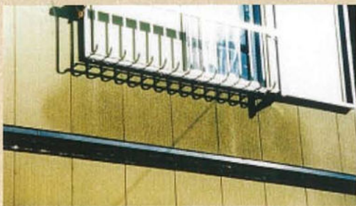
窓の下シミのような汚れは、結露によるカビ。日中、壁内の湿気が温度上昇によって水蒸気となり、夜に冷えた窓枠に触れて結露したと思われる
