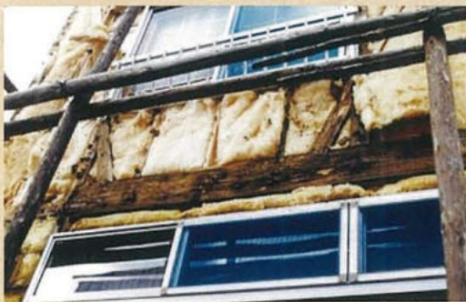
まだ断熱・気密の技術が浸透していない頃、壁内結露によって柱や梁が腐ってしまう家も少なくなかった
