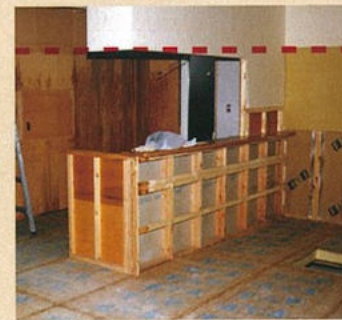
キッチン空間の解体作業の様子。左側の壁に水が浸水した跡が残っている
