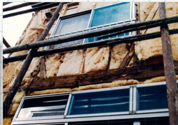
経年劣化し、ずれ落ちた断熱材。周囲の柱なども腐ってしまった腐食した土台部分
