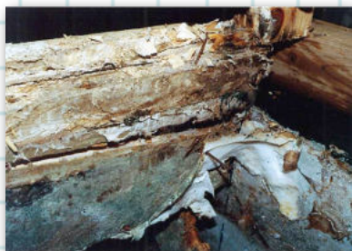
土台部分に腐朽菌（ナミダダケ）が発生し、経年劣化し、ずれ落ちた断熱材。周囲の柱なども腐ってしまった腐食した土台部分
