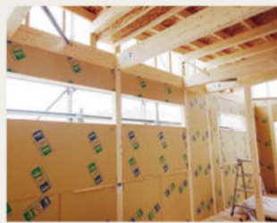
ウレタン断熱パネルを建物の躯体に組み込んだ現場の様子。
