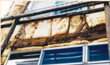
経年の水分の吸収と自らの重さでスレ落ちた繊維系断熱材の例
