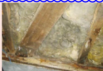
結露が木(構造体)を腐らせ、建物の性能を著しく低下させている劣化具合の例
